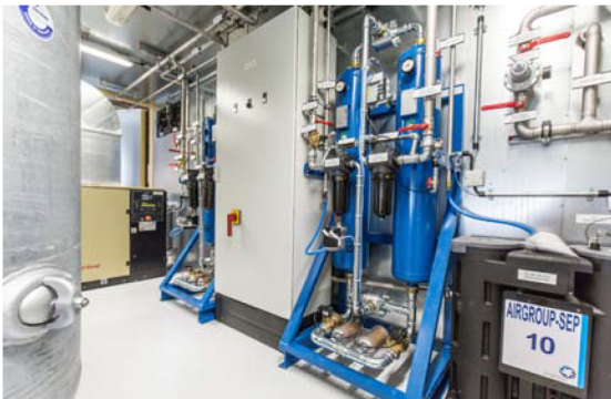
Steuerluftstation in einem Container
